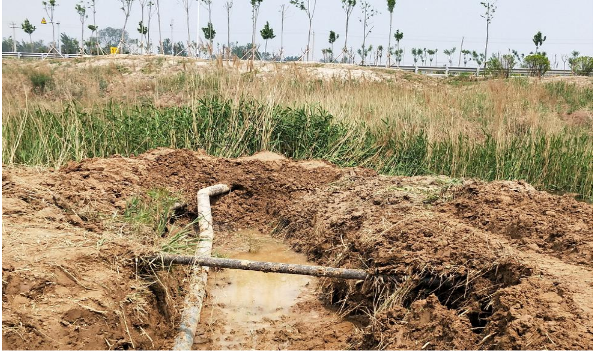
图 2.3-5 林东 4 号配水间至林东 2 号配水间注水支干线腐蚀穿孔照片
