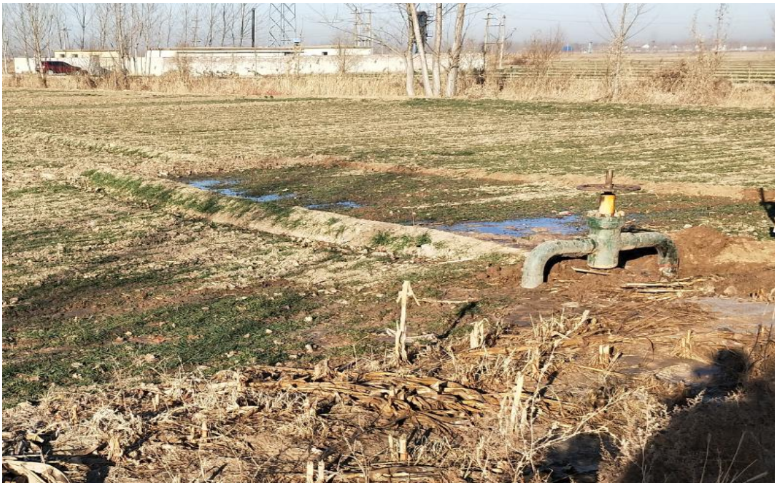
图 2.3-3 林东 8 至 4 号配水间注水干线腐蚀穿孔照片
