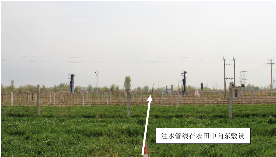
图 5.1-2 林东 8 号站-林东 4 号站注水干线走向现场图 2
